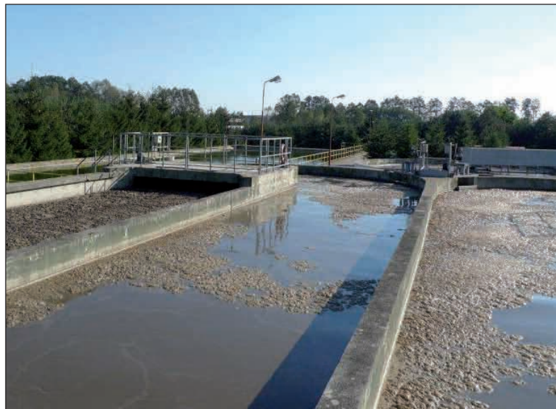
Rzgowska oczyszczalnia ścieków
